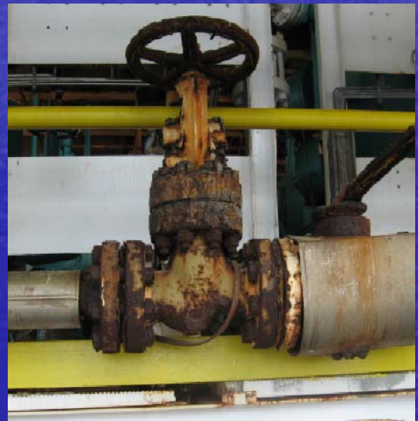
其它保溫之殘留水造成之閥件腐蝕
